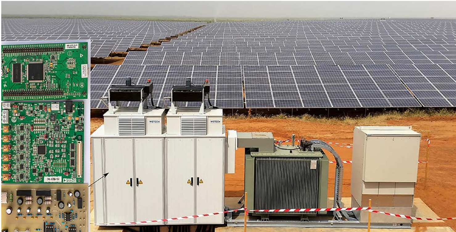
Das Add-On zur aktiven Netzspannungsfiltration (links), mit dem die Spannungsqualität des Netzes verbessert werden kann, wird in einem PV-Wechselrichter (Mitte) erprobt.
