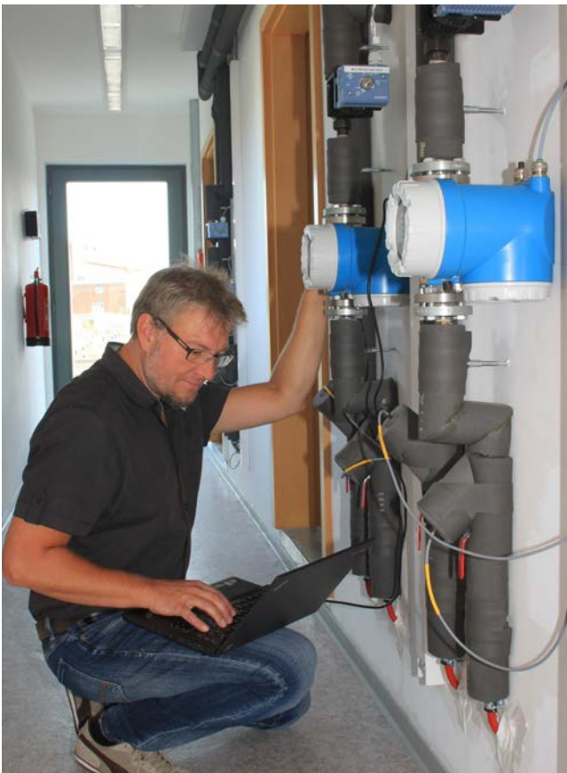
Durch Setzen von Steuerbefehlen prüft ein Projektmitarbeiter an seinem Laptop die Funktionalität der im Schaltschrank installierten Steuereinheiten.
