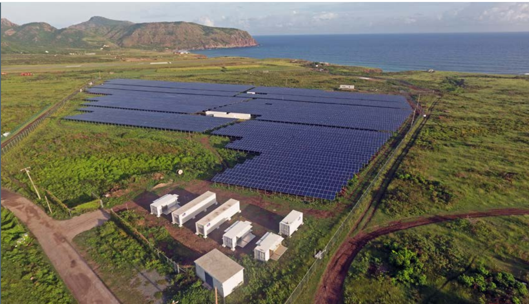
Die Karibikinsel St. Eustatius (4.000 Einwohner) wird vom neuen PV-Diesel-Hybrid-system mit Strom versorgt.
