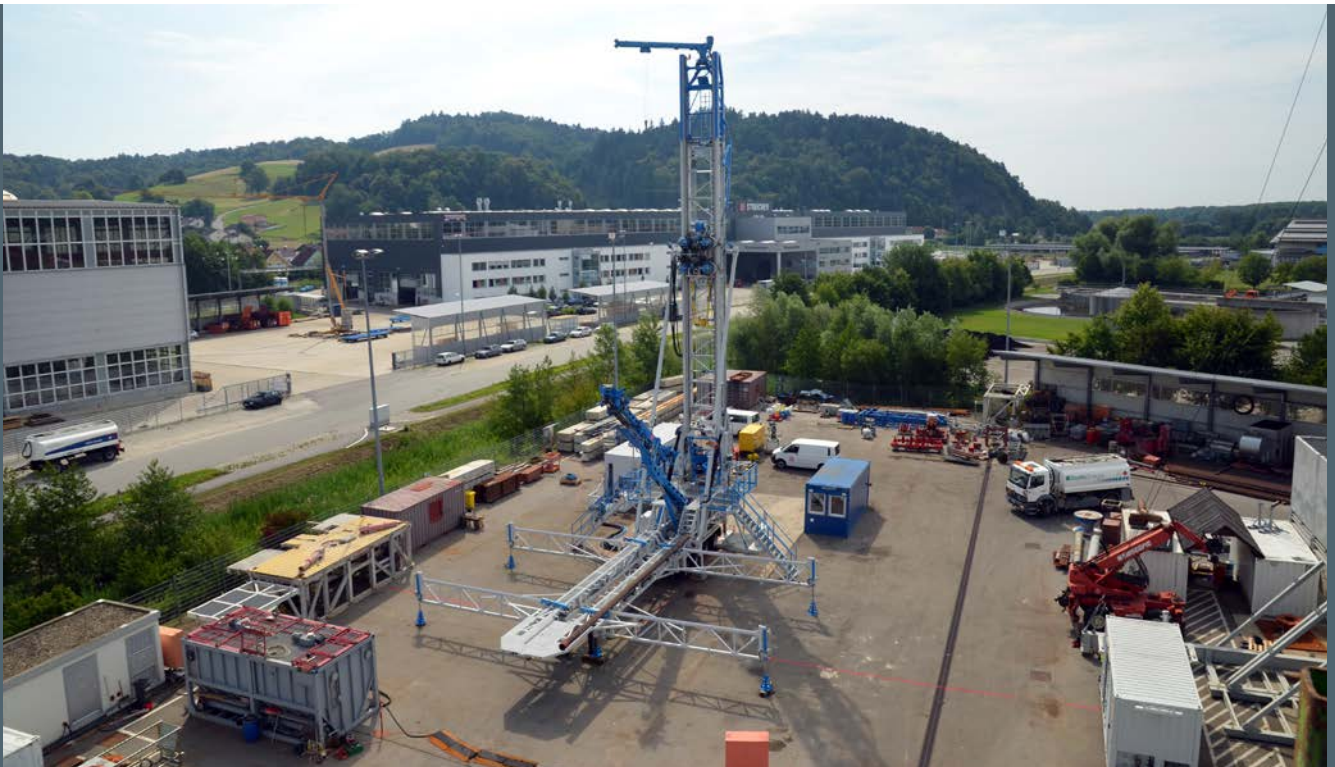
Die Geothermie-Workover-Anlage steht hier betriebsbereit auf dem Testplatz in Deggendorf.
